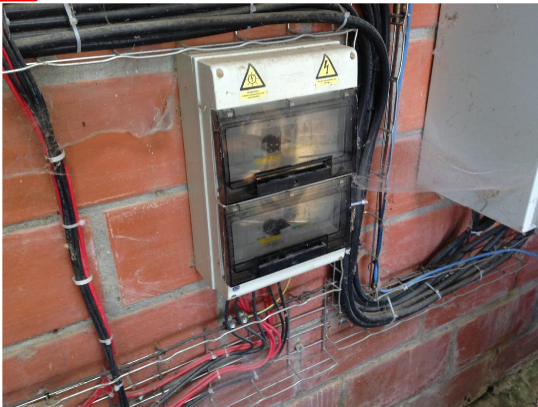
Figure 3 : Les coffrets DC sont aussi poussiéreux.
