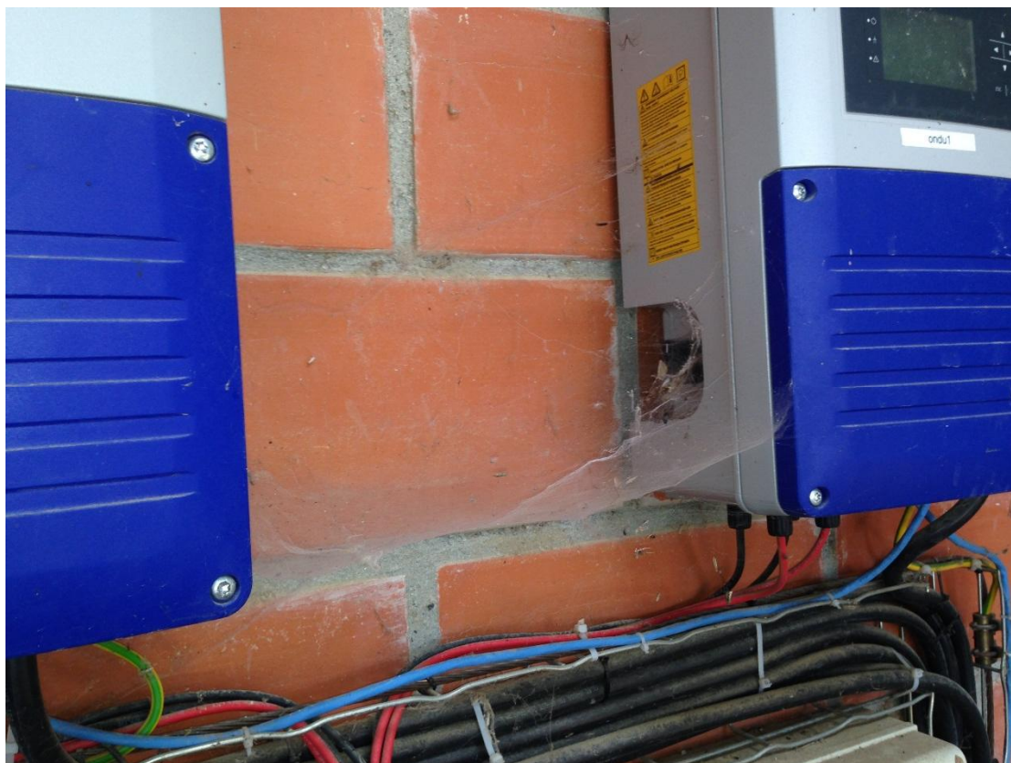
Figure 2 : Il y a de la poussière sur les câbles et des toiles d'araignées entre les onduleurs.
