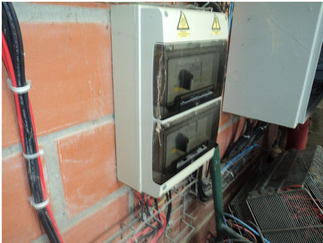
Figure 3 : Les coffrets DC sont aussi poussiéreux.
