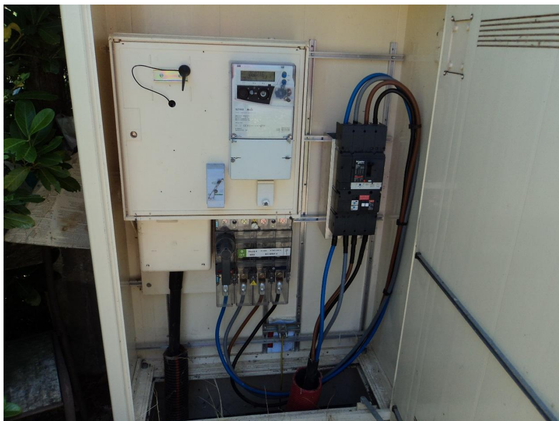
Figure 6 : Disjoncteur AGCP de l'installation.
