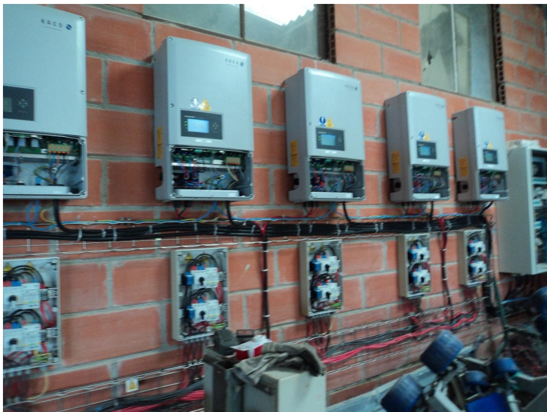
Figure 4 : Ouverture des onduleurs et des coffrets DC après le nettoyage pour les différentes prises de mesures.
