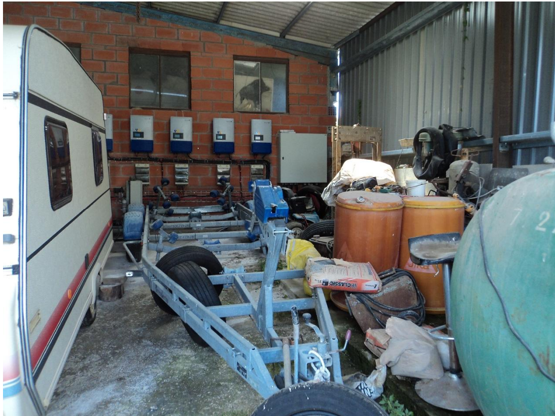
Figure 1 : Le local est très encombré à notre arrivée, les onduleurs sont difficilement accessibles.
